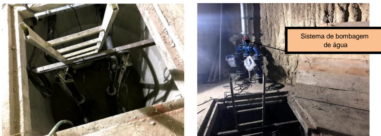
Figura 64 (obtida no local da obra a 19 de julho de 2018): Poço de acumulação de água (à esq.) e do respetivo sistema de bombagem da mesma (à dir.)
