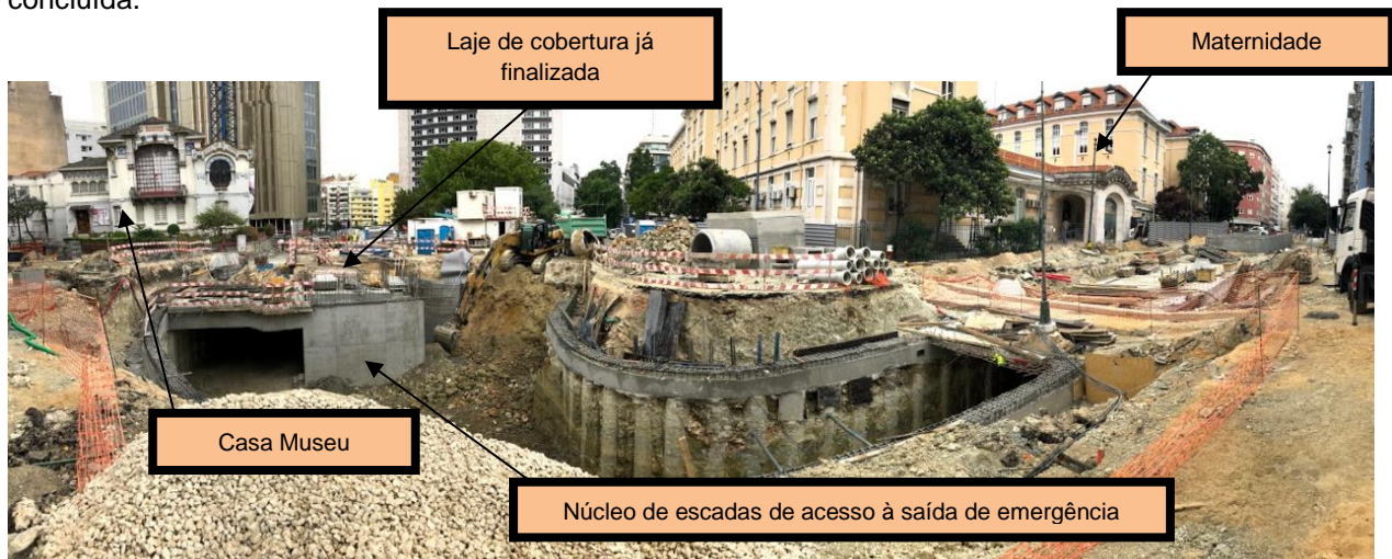
Figura 33 (obtida no local da obra a 20 de junho de 2018): Finalização dos trabalhos de escavação na zona central do túnel
