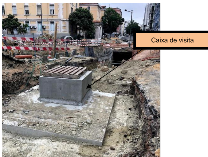
Figura 35 (obtida no local da obra a 20 de junho de 2018): Coletor praticamente enterrado e respetiva caixa de visita
