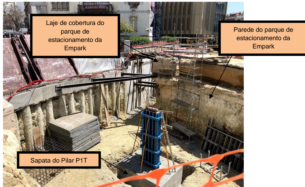
Figura 21 (obtida no local da obra a 7 de maio de 2018): Pormenor de uma das sapatas de suporte aos pilares
