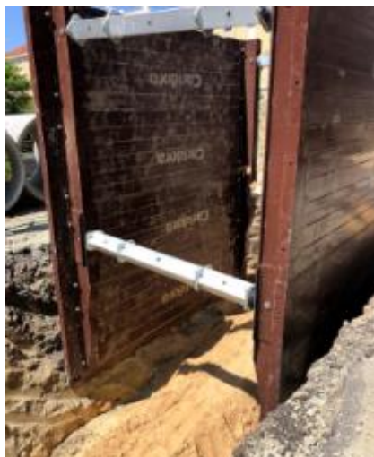
Figura 24 (obtida no local da obra a 21 de maio de 2018): Pormenor do recurso à entivação e à colocação de areias sobre o coletor
