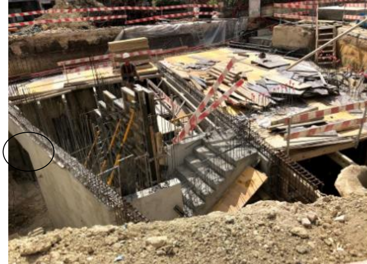
Figura 30 (obtida no local da obra a 5 de junho de 2018): Início dos trabalhos relativos à execução da laje de cobertura, na zona central do túnel
