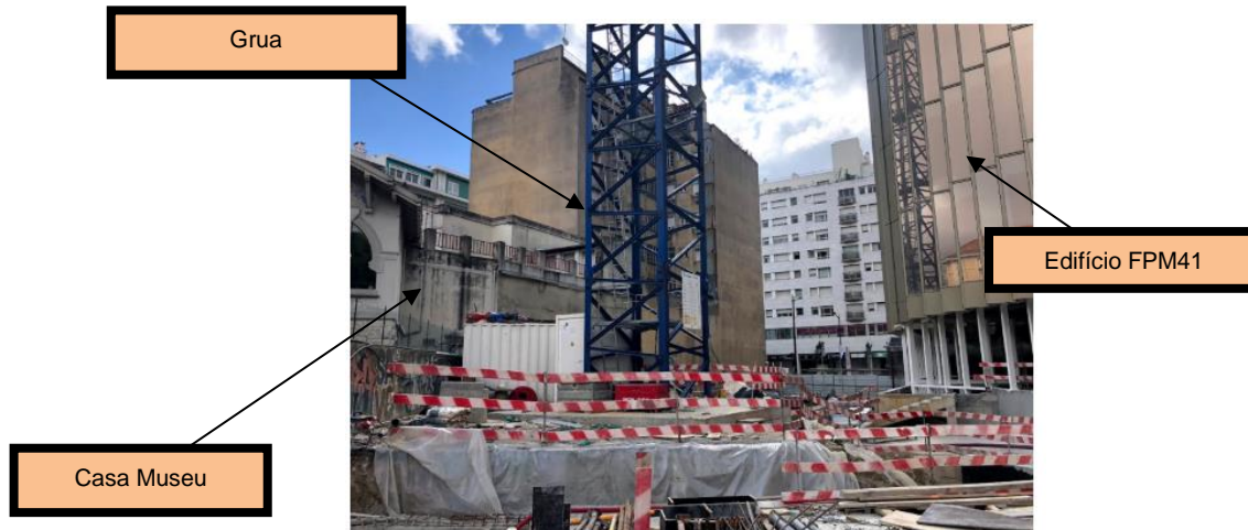
Figura 66 (obtida no local da obra a 28 de maio de 2018): Posicionamento da grua
