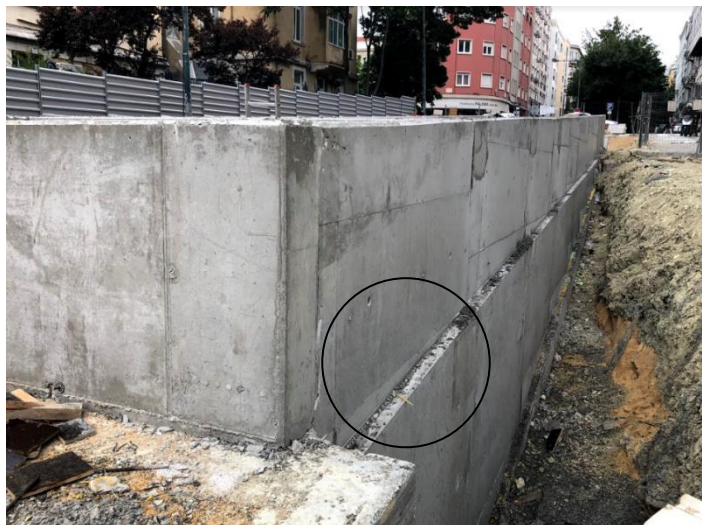
Figura 34 (obtida no local da obra a 20 de junho de 2018): Pormenor da diminuição de espessura das paredes do túnel, na zona junto à Maternidade Dr. Alfredo da Costa
