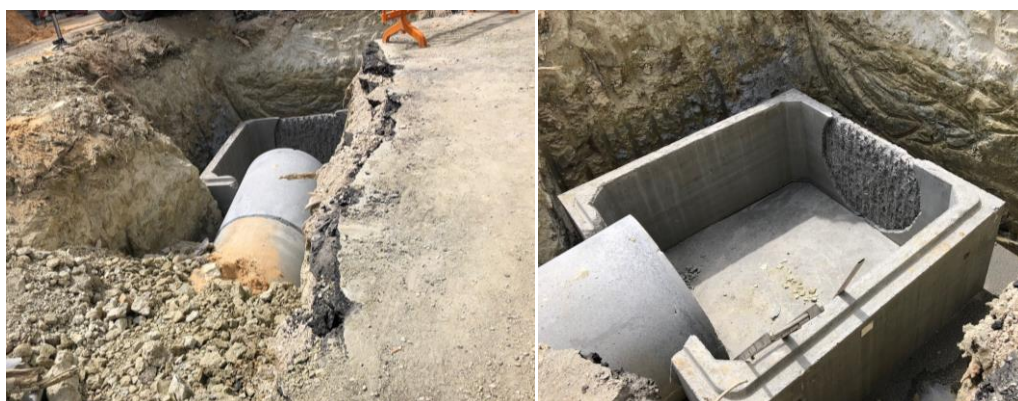
Figura 18 (obtida no local a 19 de abril de 2018): Pormenor da instalação do novo coletor
