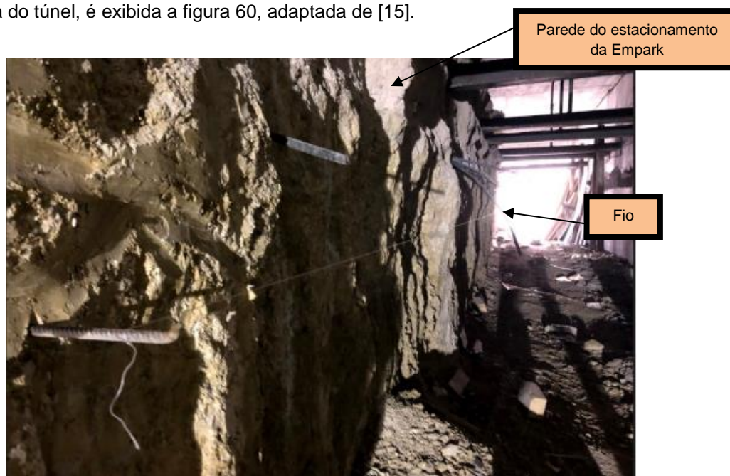
Figura 59 (obtida no local da obra a 28 de maio de 2018): Pormenor da instalação do fio-de-prumo ao longo da parede do parque “Saldanha” da Empark
