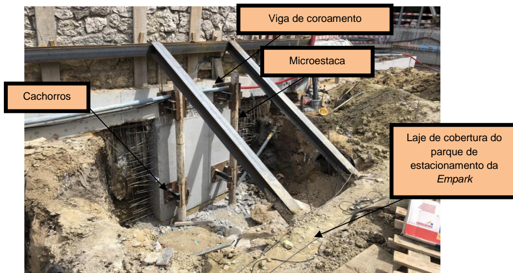
Figura 52 (obtida no local da obra a 19 de abril de 2018): Pormenor da instalação de escoras provisórias, da laje de cobertura onde estas se apoiam, dos cachorros e das microestacas
