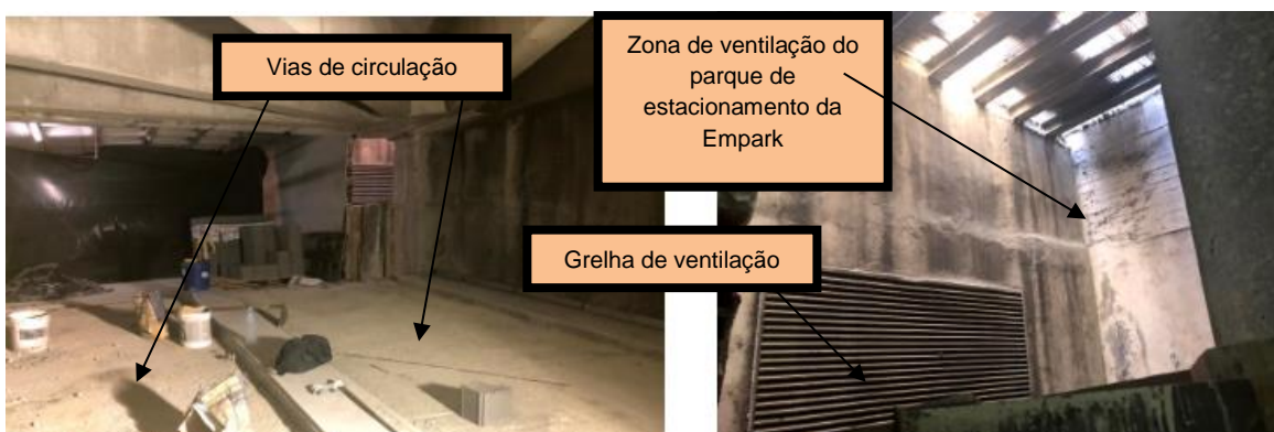
Figura 42 (obtida no local da obra a 9 de agosto de 2018): Zona de ligação entre o túnel e o parque de estacionamento existente (à esq.) e pormenor da grelha de ventilação do parque existente (à dir.)
