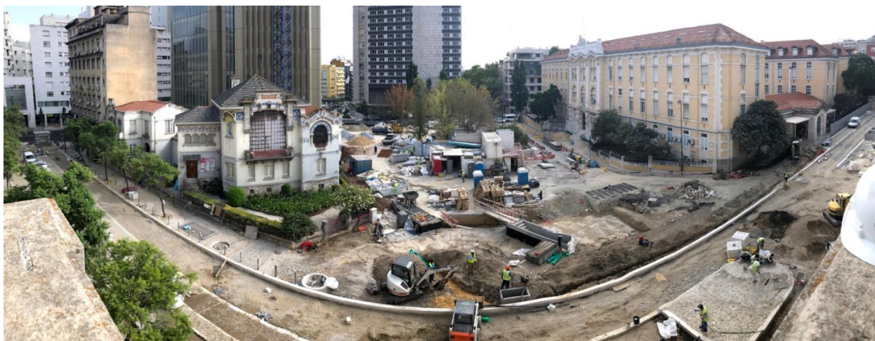
Figura 47 (obtida no local da obra a 27 de agosto de 2018): Avanços à superfície
