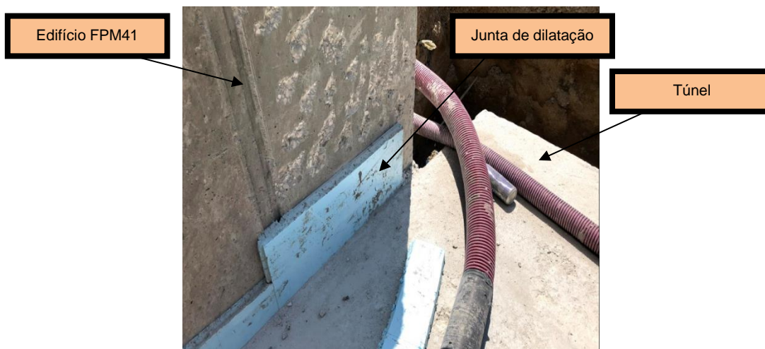
Figura 12 (obtida no local da obra a 7 de maio de 2018): Junta de dilatação entre o edifício FPM41 e o respetivo túnel de acesso
