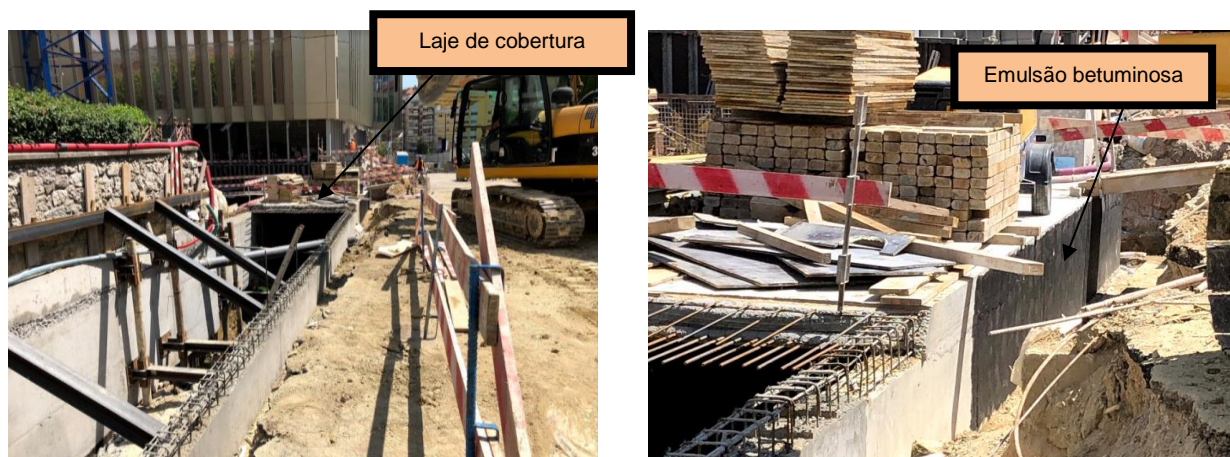
Figura 56 (obtida no local da obra a 7 de maio de 2018): Execução da laje de cobertura do túnel (à esq.) e aplicação da emulsão betuminosa para proteção do betão enterrado (à dir.)
