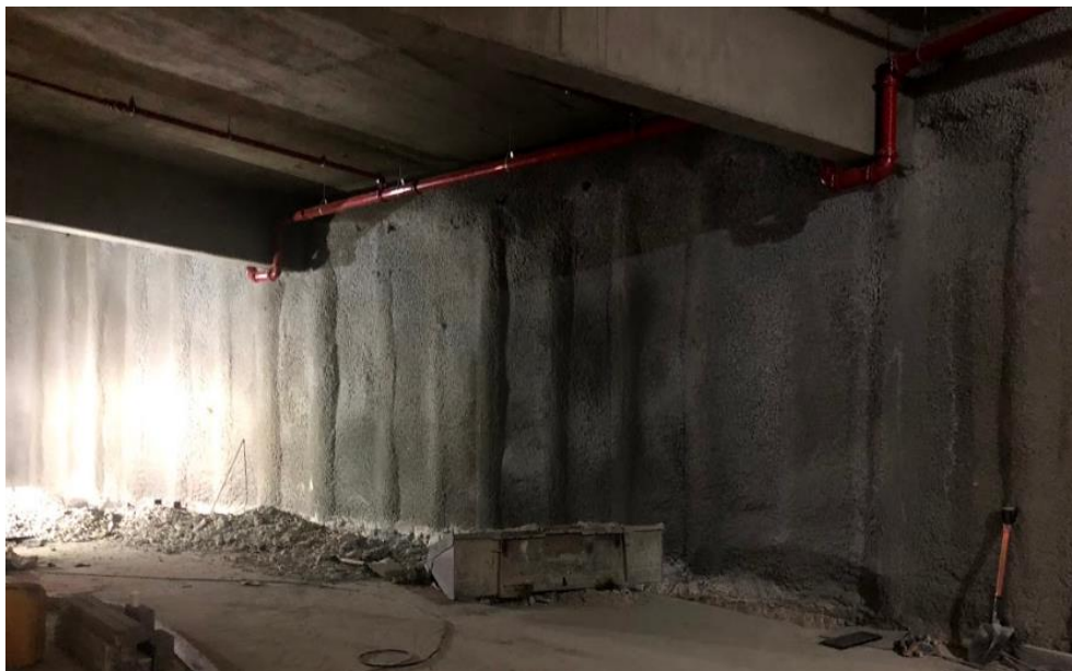
Figura 44 (obtida no local da obra a 9 de agosto de 2018): Paredes do túnel
