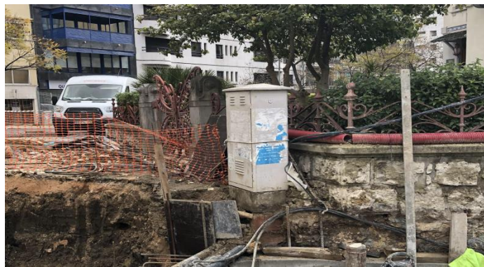
Figura 7 (obtida no local da obra a 4 de abril): Pormenor da localização da caixa responsável pelos semáforos que condicionou o desenvolvimento do túnel
