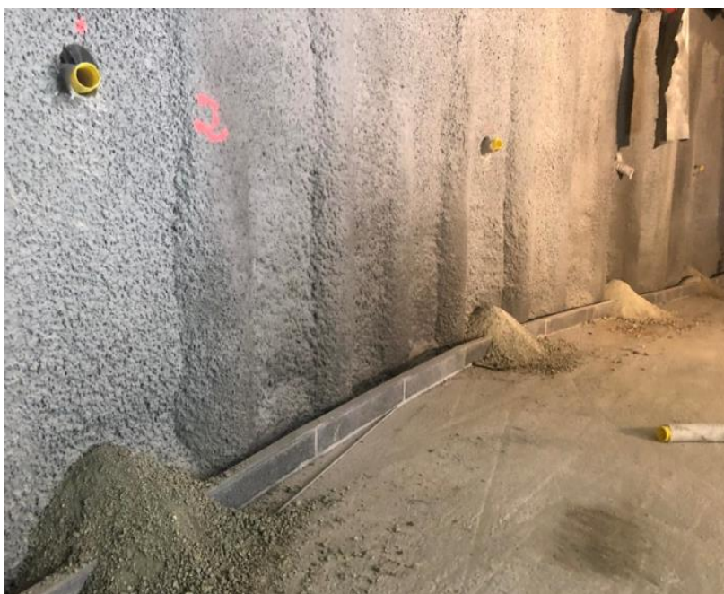
Figura 45 (obtida no local da obra a 9 de agosto de 2018): Colocação dos geodrenos
