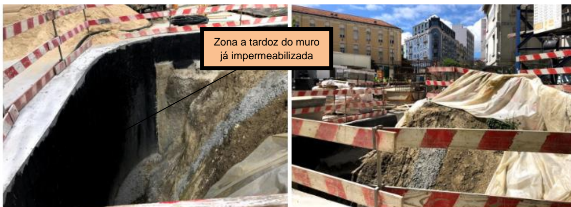
Figura 68 (obtidas no local da obra a 5 e a 8 de junho de 2018, respetivamente): Zona a tardo do Muro de Suporte
