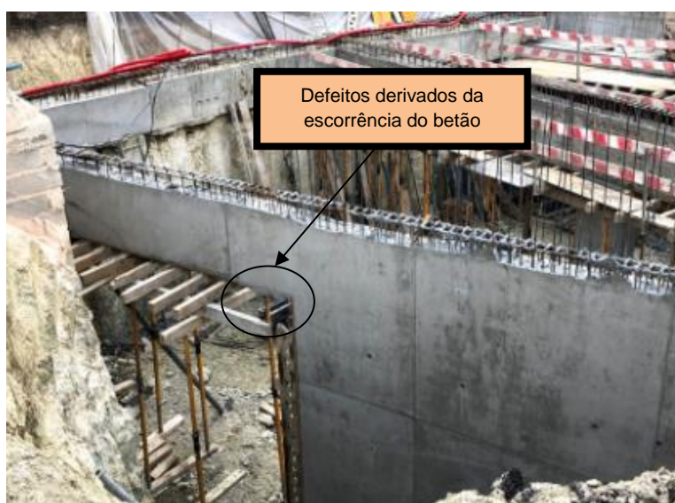
Figura 29 (obtida no local da obra a 28 de maio de 2018): Pormenor da inexistência de escoramento adequado na construção da parede do núcleo de escadas
