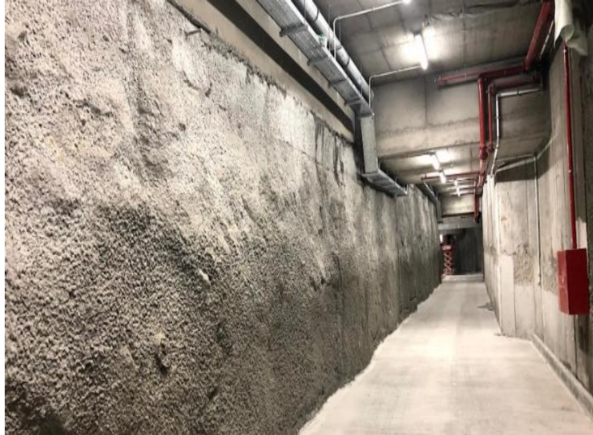
Figura 65 (obtida no local da obra a 17 de setembro de 2018): Parede do túnel oposta à contenção realizada através da projeção de betão
